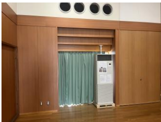
2階集会室に設置された代替機（カーテン横）
